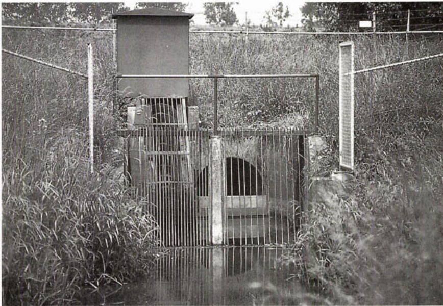
FIGUUR 4. Het vijzelgemaal met stuw bij Ophoven (foto: S. Jansen).
